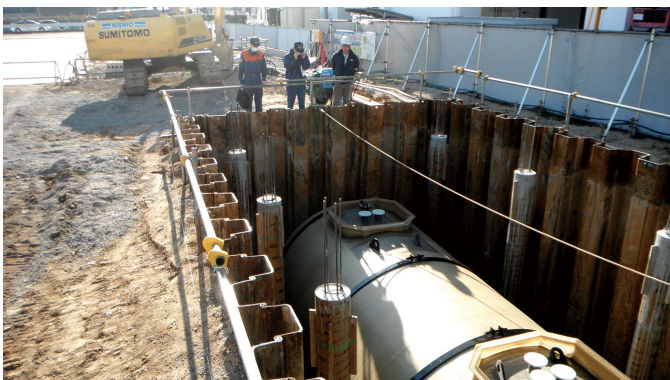
地下タンク検査
